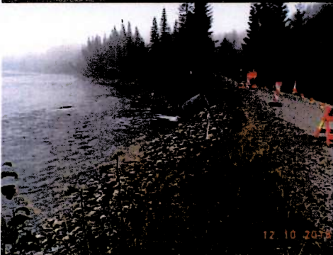
Erosjonsutsatt parsell sett motstrøms, med Øvergårdselvkulverten.
