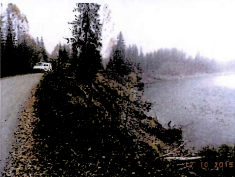
Nedre del av erosjonsutsatt parsell, sett medstrøms.
