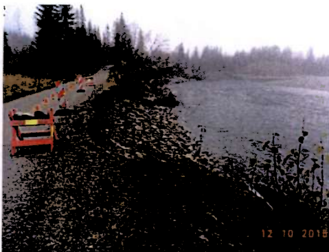
Erosjonsutsatt parsell sett medstrøms Oppstrøms ende av sikringstiltaket blir mot fulvert fra Øvergårdselva.
